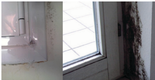
Σχήμα 3.4.5: Εμφάνιση μούχλας λόγω κακής στεγανοποίησης
